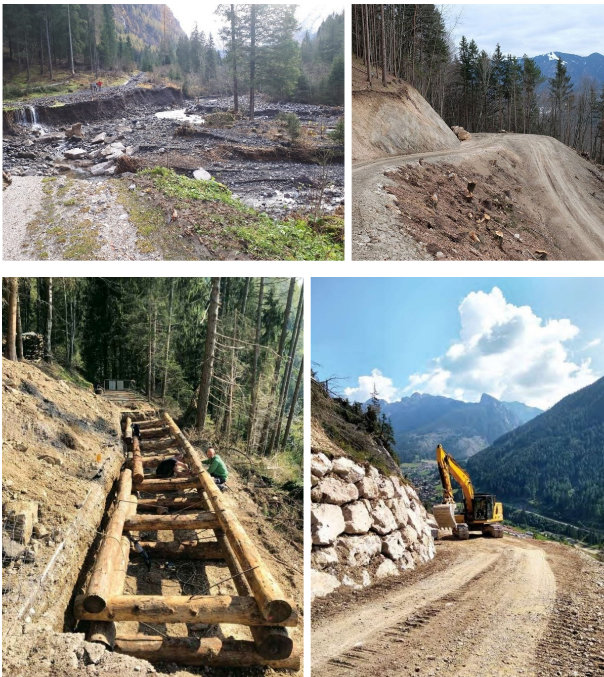
Fig. 6 – Proposte di intervento e di nuova viabilità. In situazioni emergenziali di dissesto idrogeologico, la viabilità forestale può essere seriamente compromessa (sopra a sinistra: strada forestale distrutta dalla Tempesta Vaia in Valle di Gares, BL; fonte: Archivio Radio+ Emittente Agordina) richiedendo interventi di ripristino (sotto a sinistra: ripristino di un tratto di strada forestale nell'UDF di Primiero, TN; fonte: AA. VV., 2022). In alcuni casi gli standard dei vecchi criteri tecnici costruttivi non sono idonei al passaggio dei moderni mezzi forestali e si manifesta la necessità di intervenire con interventi di adeguamento (sopra a destra: rifacimento di un tornante per rendere una strada forestale transitabile da autotreni in Carinzia, AUT; fonte: Grigolato et al., 2019). In altri casi si manifesta la necessità di costruire un nuovo tratto di viabilità forestale/silvo-pastorale per migliorare il servizio al bosco e, dunque favorire le utilizzazioni forestali, o per eseguire un intervento più specifico di protezione del territorio, come strade tagliafuoco, sistemazioni idraulico-forestali ecc. (sotto a destra: nuovo tratto stradale nel Comune di Moena, TN; fonte: AA. VV., 2022).
